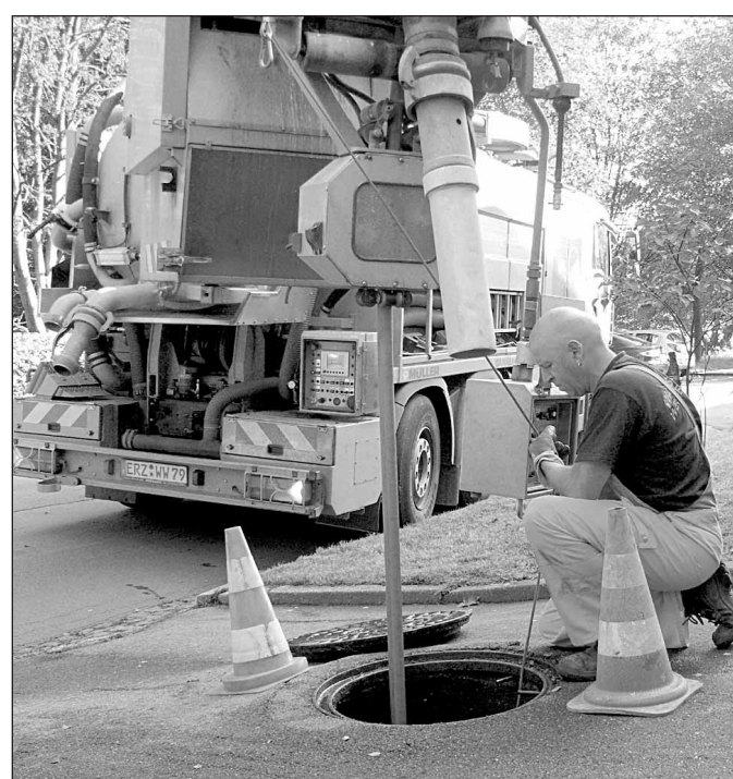
Der Mitarbeiter der Wasserwerke Westertal Gert Wahl bei der Hochdruckreinigung eines verstopften Kanals in einem Wohngebiet.
